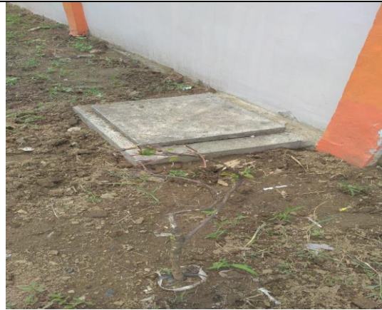
Saluran pembuangan yang masuk langsung ke saluran IPAL RSUD
