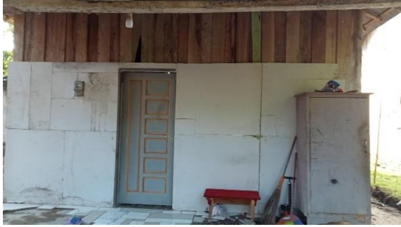
Rumah responden tidak ada ventilasi dan jendela
