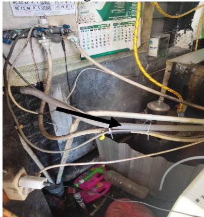
Gambar 3. Saluran pipa yang langsung terhubung ke badan air
