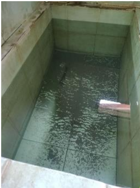
Kondisi bak air di SDN Trosono 1
