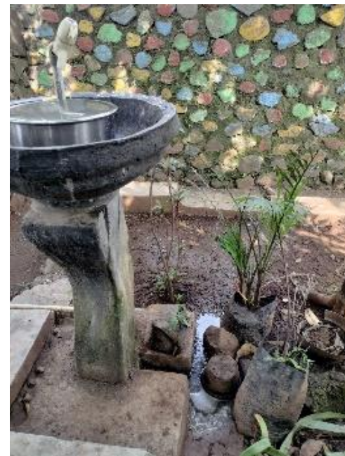
Kondisi pembuangan air wahtafel di SDN Trosono 2
