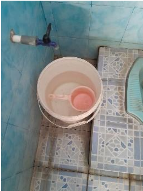
Kondisi toilet siswa Di SDN Mategal 2
