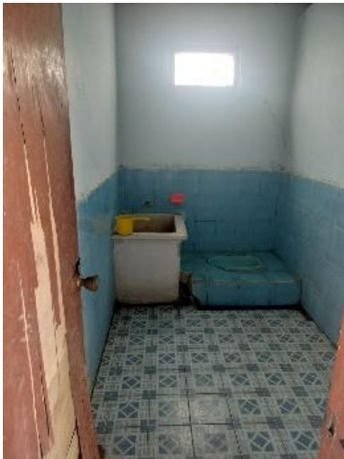
Kondisi jamban Di SDN Mategal 1
