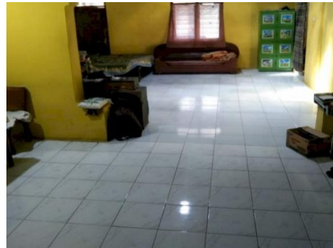
Kondisi lantai rumah yang tidak memenuhi syarat
