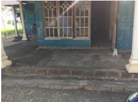
Kondisi lantai rumah yang tidak memenuhi syarat
