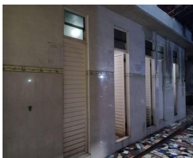
Gambar 7. Kondisi Kamar Mandi
