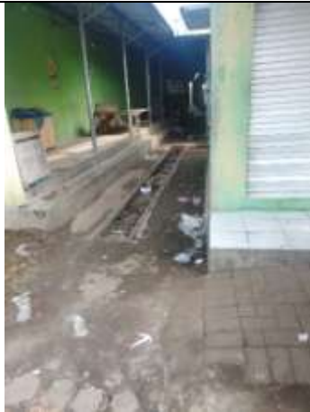
Kondisi Saluran Air
