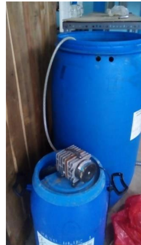
Gambar 15. Bak aerasi dan aerator
