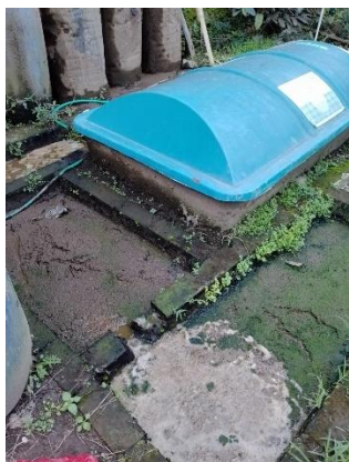
Gambar 19. Instalasi biogas di Desa Puntukdoro
