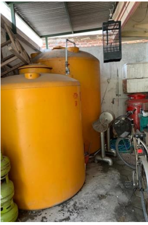
Kondisi tabung air baku depot air minum
