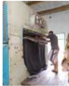
Pengaturan debit air limbah pada bak aerasi 2
