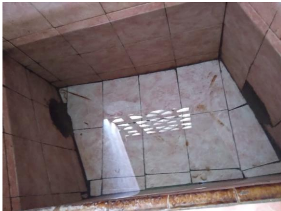
Kondisi Air di Dalam Kamar Mandi
