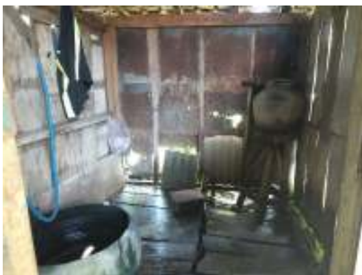
Kondisi Kamar Mandi
