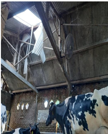
Gambar.3 Kondisi atap kandang yang sudah rusak
