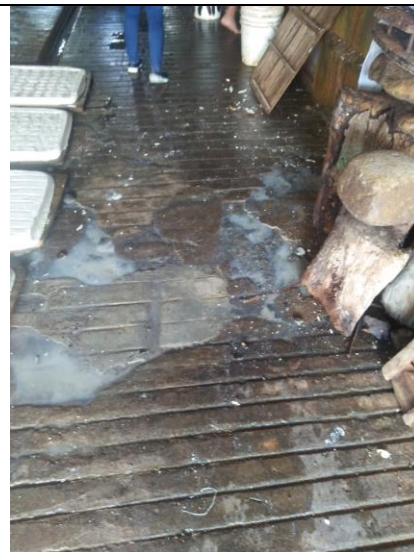
Kondisi lantai pabrik tahu yang terkena limbah pabrik yang dapat menyebabkan terpeleset
