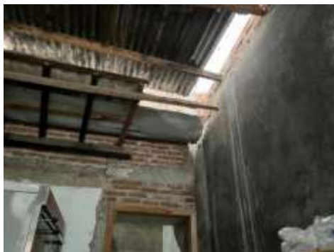
Kondisi Atap Tempat Pengolahan Makanan
